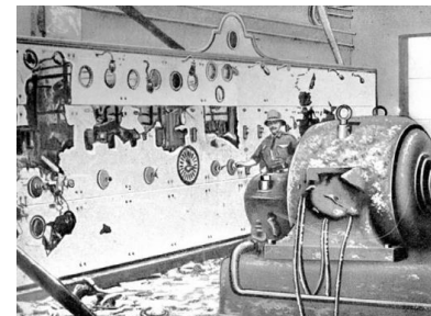
Abb. 33: Kamina, die zerstörte Schalttafel
